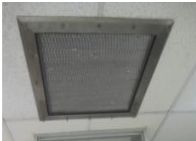
Fotografía del techo de la sala de filtros, donde se observa el filtro HEPA para prevenir ingreso de partículas.
