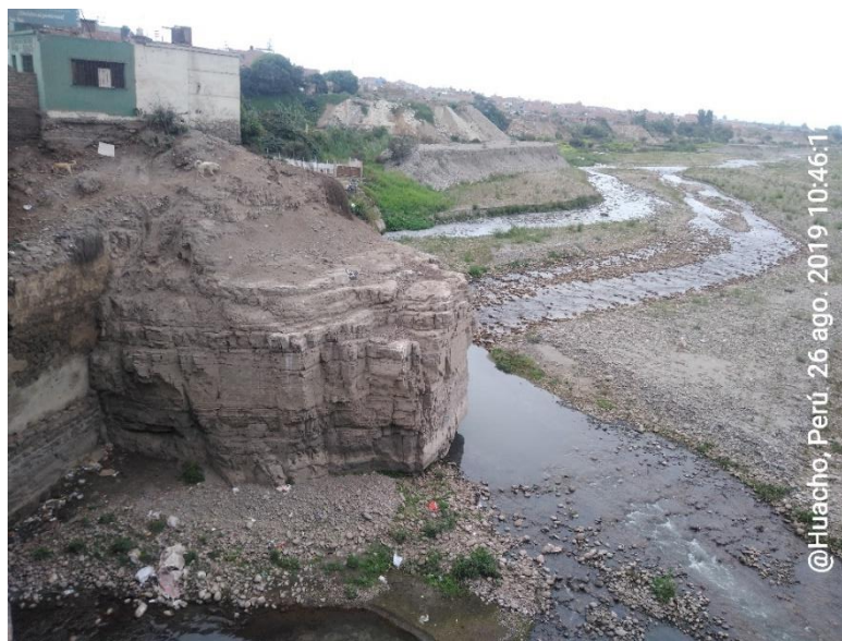
Figura 17. Erosión fluvial en la margen derecha del río Huaura (Coord. 216265 E – 8774710 N)
